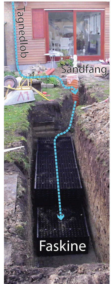
Figur 4: Faskine under udførelse. Tagvandet ledes via en sandfangsbrønd (lodret orange rør) til faskinen i billedets forgrund. Denne faskine er opbygget af plastkassetter. Lindevang, Brøndby. Foto Spildevandscenter Avedøre.
